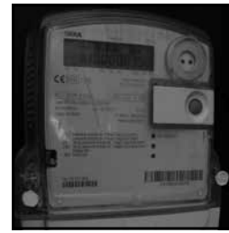
De nieuwe stroommeter en je zonnepanelen
