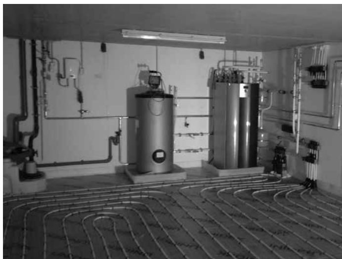
Warmtepomp en vloerverwarming
