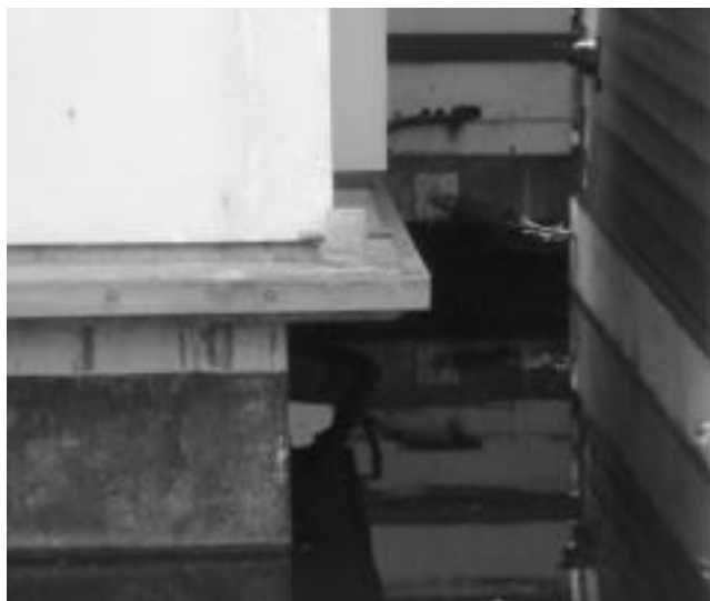
Aan beide kanten verticale muren en de steiger door de meterkast geblokkeerd
