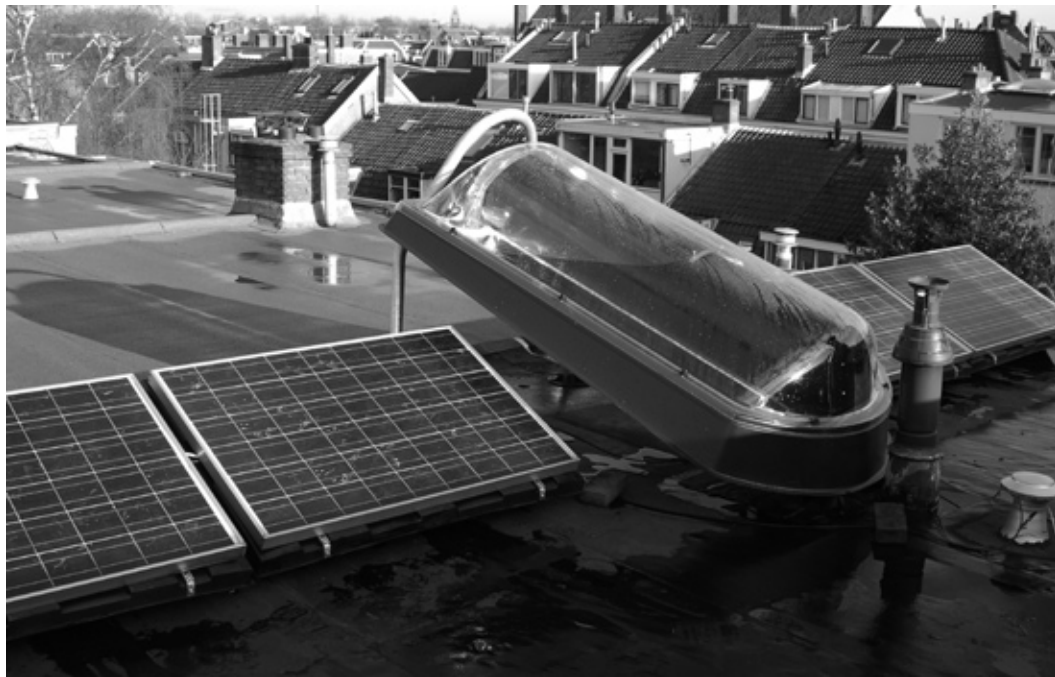
Solior FL150 zonneboiler met zonnepanelen erbij: Darth Vader in een strandligstoel?
